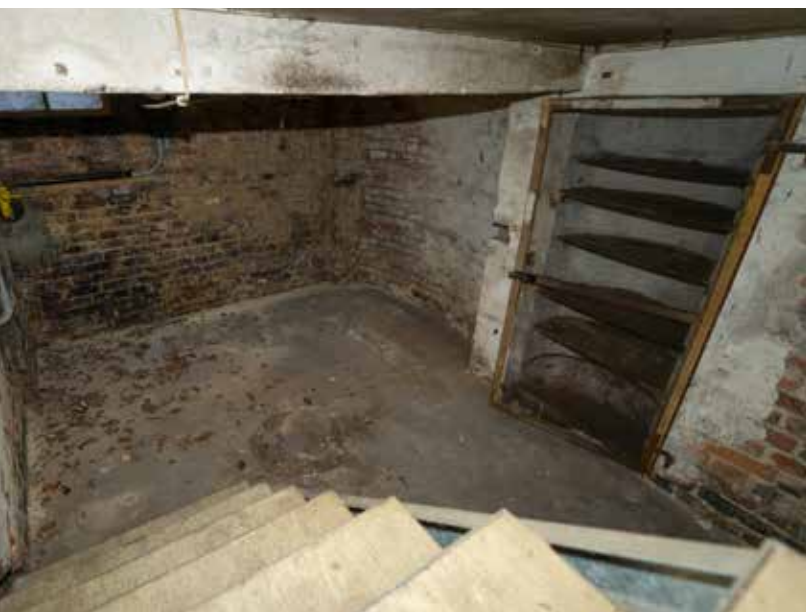
Keller zum Teil direkt ohne Fundament in den Boden gebaut.
