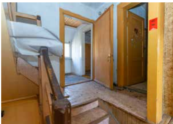
Sicherheitsproblematik: fehlende Treppensicherung bei wenig Raum
