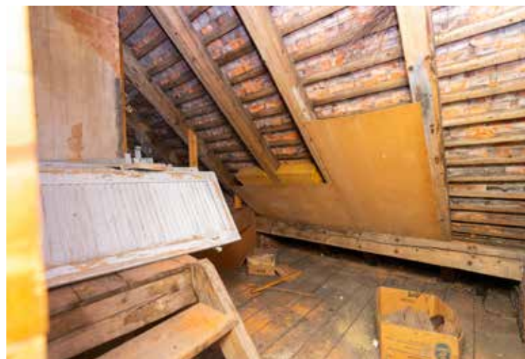
Dachstuhl und Kamine komplett sanierungswürdig
