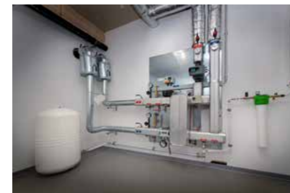
Blick in unsere Fernwärmeabnahmestation in der Degnerstraße
